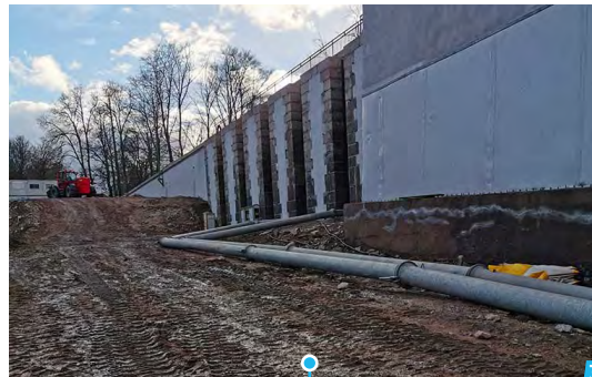
- la restauration de l'enduit d'imperméabilisation en partie haute du barrage (1 000 m 2 au dessus du niveau 15 m, qui préservera l'aspect du parement initial du barrage- futur monument historique (photo 3),
